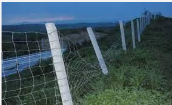
Figura nr. 6-42 Gardul neranforsat amplasat inițial pe autostrada Egnatia, dărâmat de mamiferele mari
